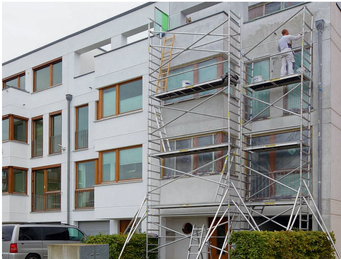
Fassaden-Sanierung: Die Kosten sollten aus dem Erneuerungsfonds bezahlt werden können
